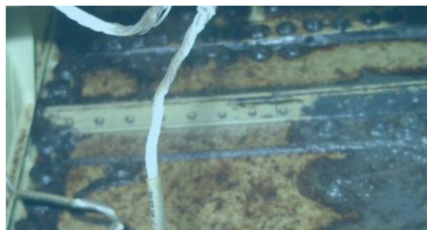
图1 油箱结构腐蚀 [12]
